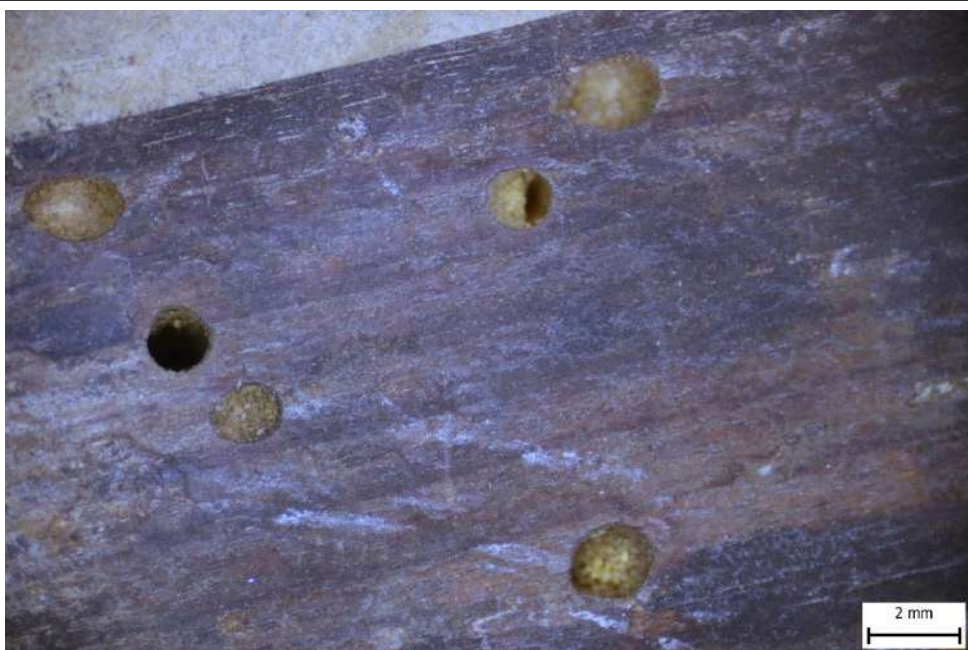
Detail poškození dřevokazným hmyzem. Typický čerstvý sypký požerok v dírkách, který může být signálem aktivity.
