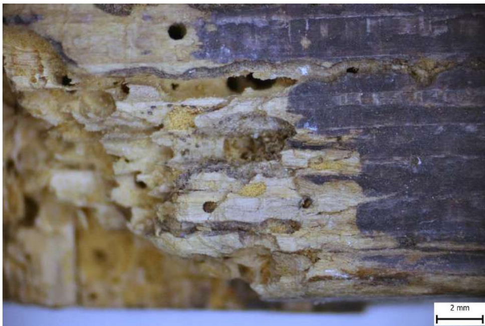
Detail devastujícího poškození rámu dřevokazným hmyzem s čerstvým požerkem.
